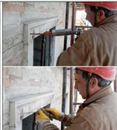
ANCORAGGIO tramite inserimento di microbarre in acciaio inox e intasamento con resina epossidica.
